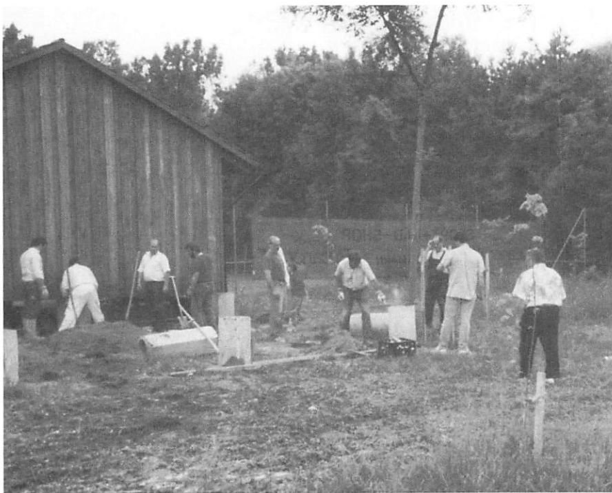
Mit viel Fleiß wurde im Juli 1995 mit dem Ausheben des Fundaments begonnen.
